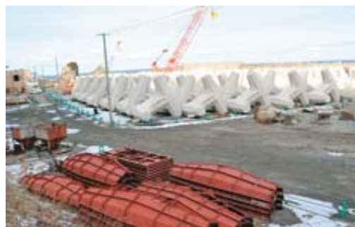
太田名部新港に置かれているドロス(波消しブロック)
